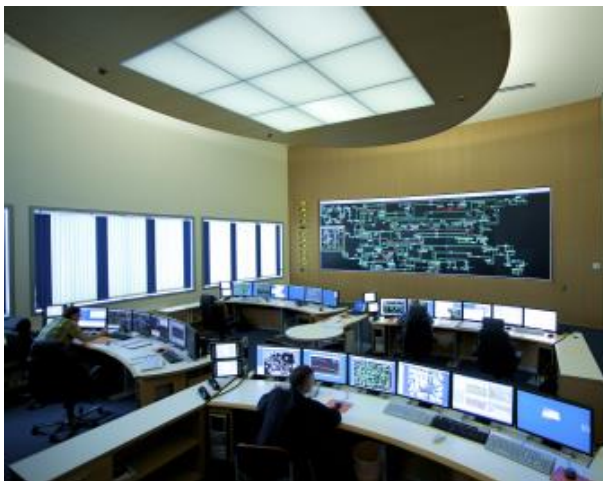
Herz der Netzführung bei 50Hertz: das Kontrollzentrum in Neuenhagen (Bild: 50Hertz)
